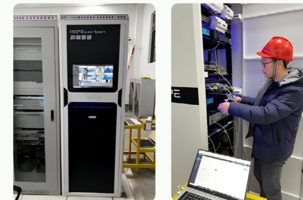
润和软件光伏全景监控一体机落地
